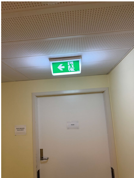
Bilde 28. Rømningskilt viser feil vei, rømning er gjennom dør.
