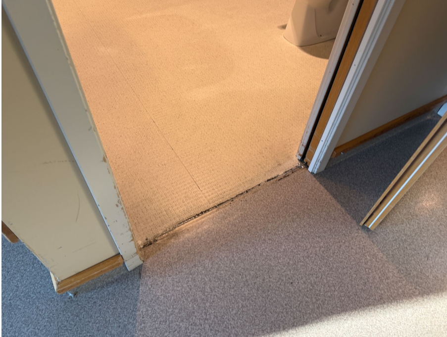
Bilde . Typisk skjemmende overgang mellom soverom og bad.
