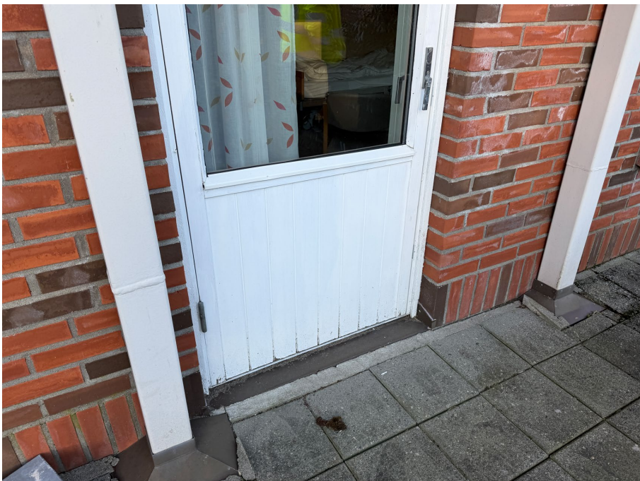
Bilde 8. Terrassedør med mindre råteskader i dørblad og glasslister.
