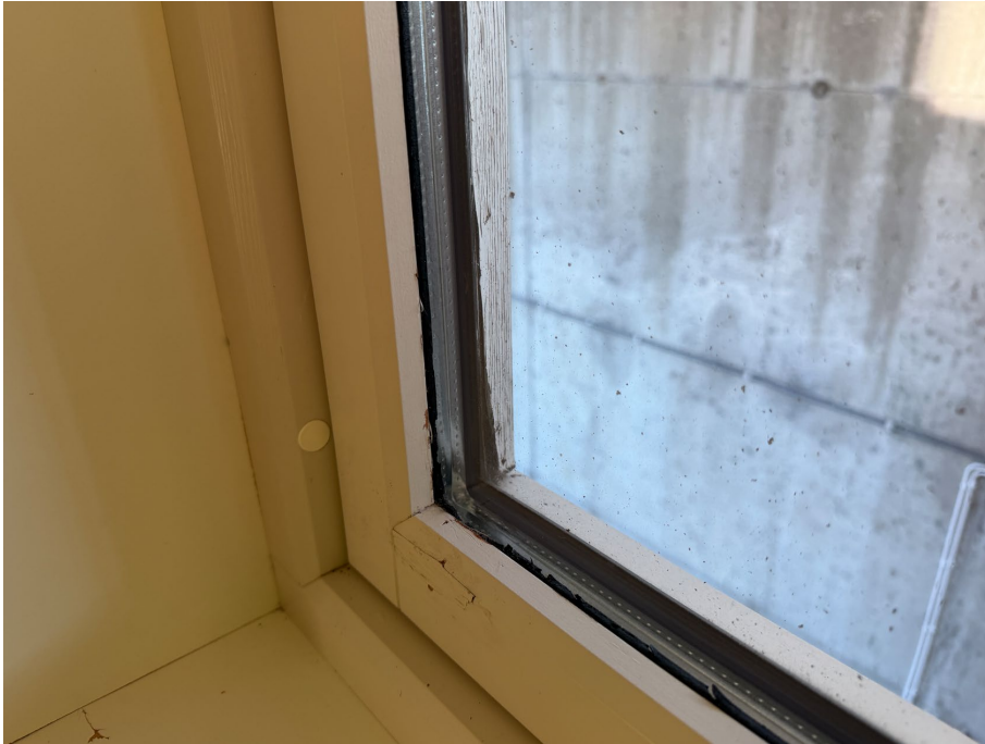
Bilde 7. Råteskadd glasslist på eldre vindu.
