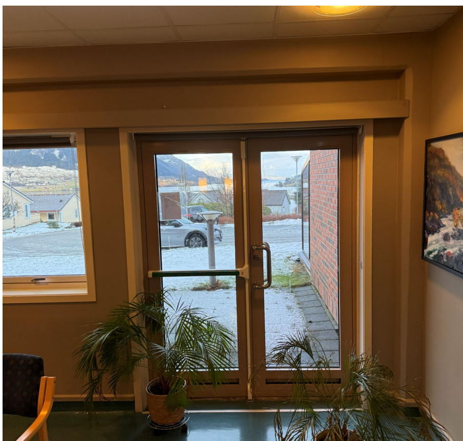
Bilde 30. Utgangsdør mangler markeringskilt.
