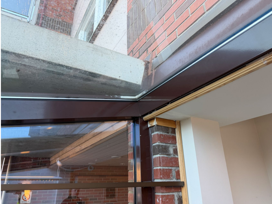
Bilde 9. Lekkasjepunkt i vinterhage.
