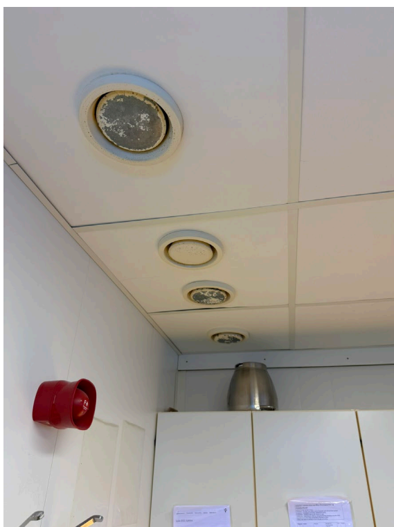
Bilde 17. Avtrekksventiler kjøkken fuktskader
