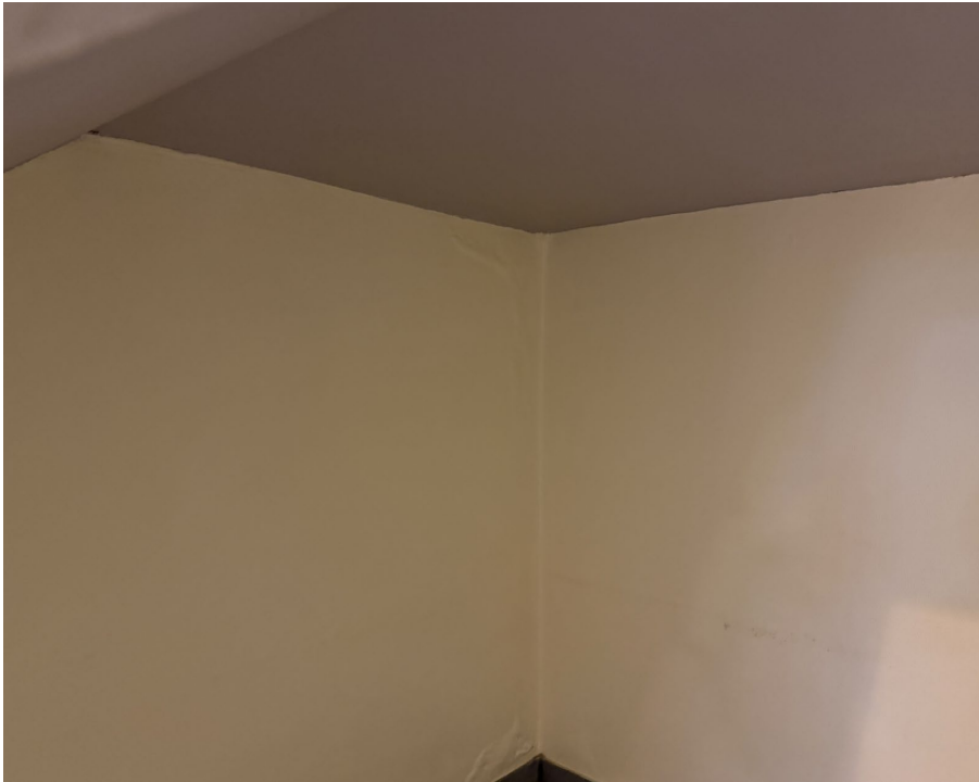
Bilde 3. Malingsavskalling i vegg mot terreng pga. fukt.
