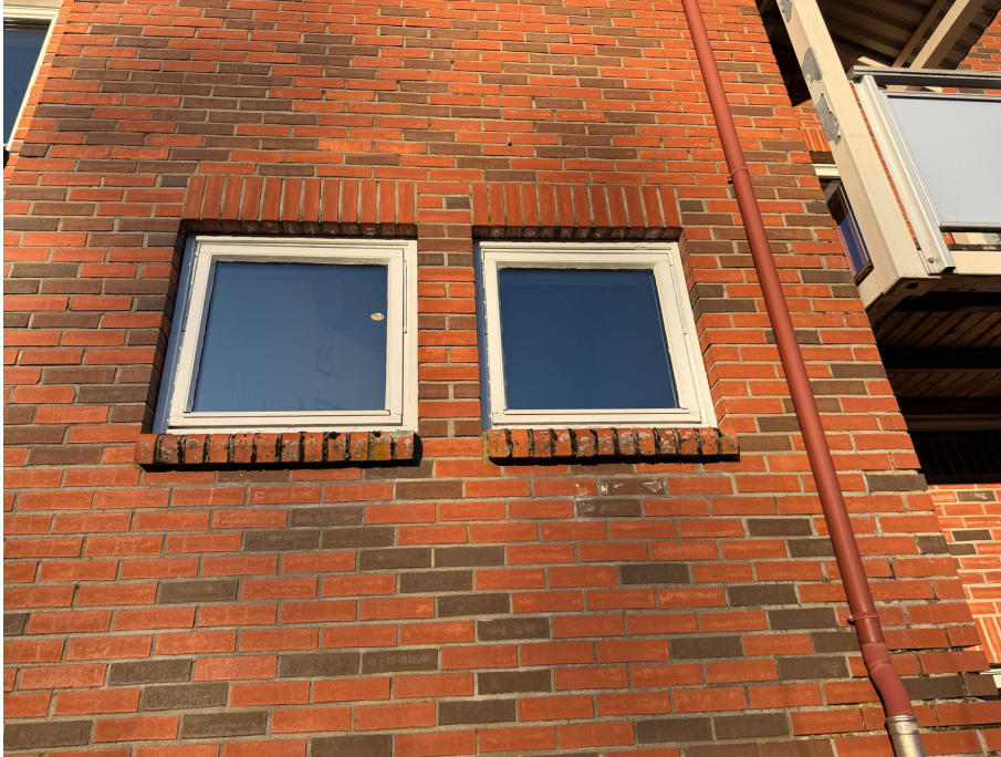
Bilde 6. Forvitring av fuger på vannbrett, samt kraftig forvitring på vegghjørne.
