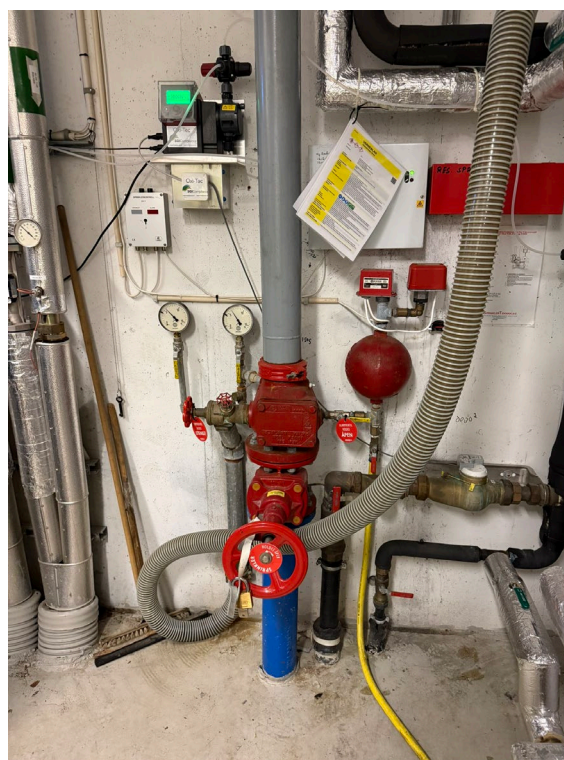
Bilde 18. Sprinklersentral med eget vanninntak.
