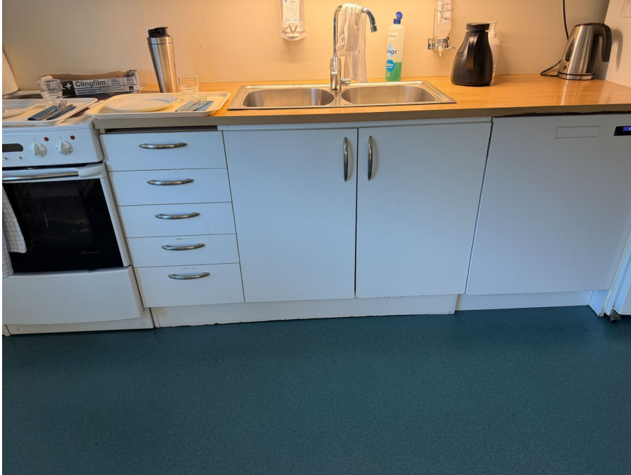
Bilde 13. Typisk kjøkken med skade på benkeplate, fronter og foringer.
