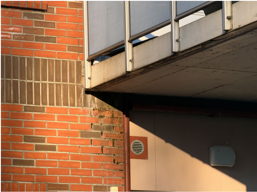
Bilde 10. Rennemerker på vegg fra balkong.
