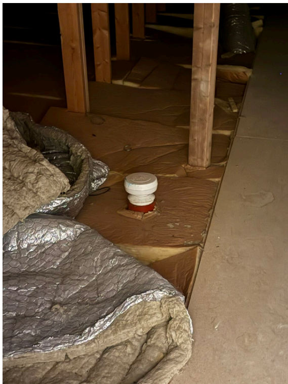
Bilde 15. Luftventil montert på spillvannsrør.
