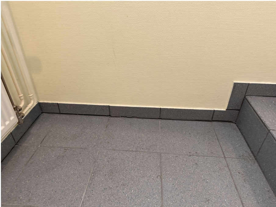
Bilde 1. Glippe mellom kantflis og gulvflis pga. bevegelser.
