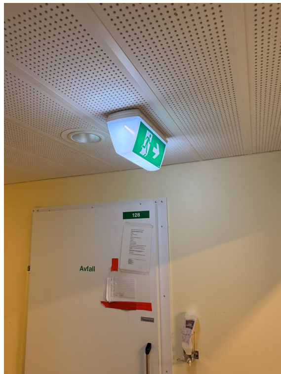
Bilde 29. Skilt viser rømning via avfall. Skilt fjernes.
