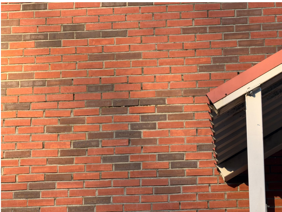
Bilde 5. Teglförblending med forvitring av fuger.
