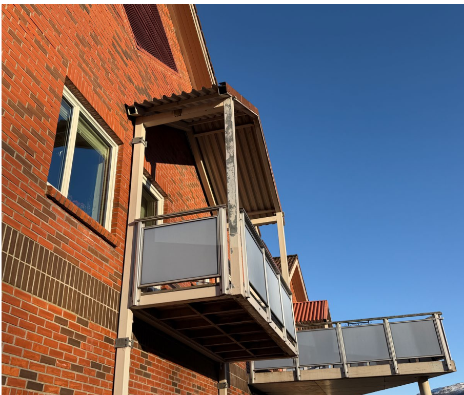
Bilde 2. Malingsavskalling på utvendige stålsøyler.
