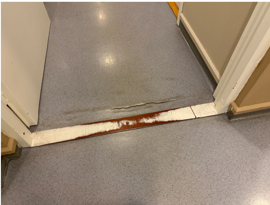
Bilde 12. Typisk skade på gulvbelegg.
