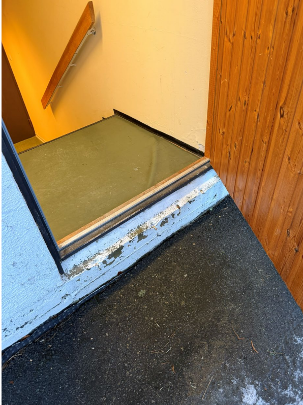
Bilde 53. Høydeforskjell ved utgangsdør.
