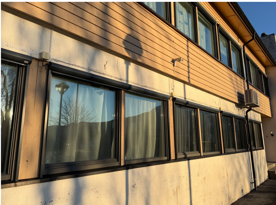
Bilde 4. Betongskader på betongfasader, 1961-bygget.
