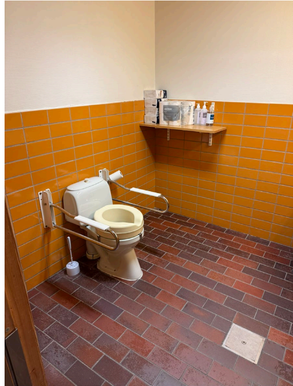
Bilde 32. HCWC moden for utskiftingning.
