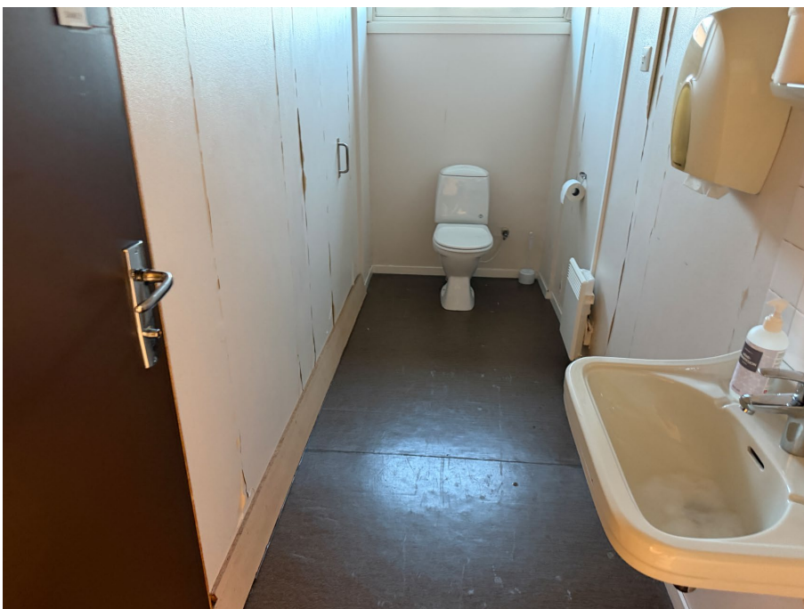
Bilde 20. Toalett med typiske skader på vegg og gulv.
