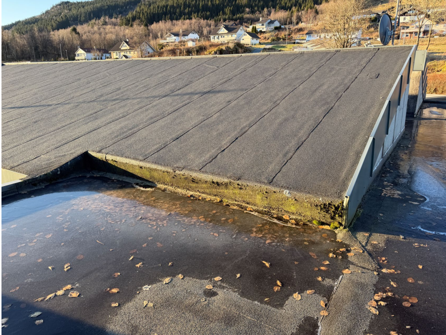
Bilde 18. Yttertak med mangelfullt fall og med kraftige kuldebroer (betongvegger).
