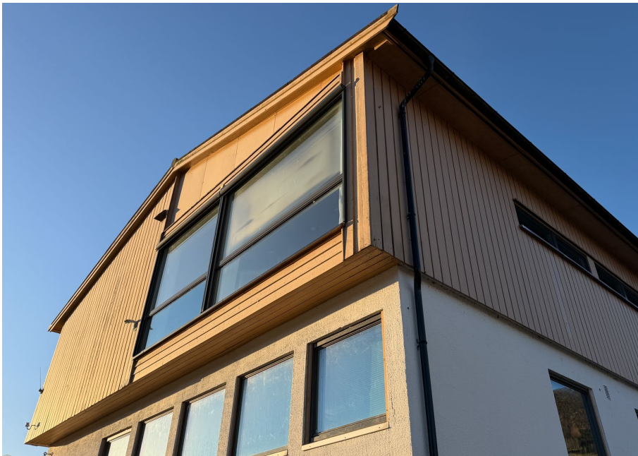
Bilde 6. Råteskader på trekledning, samt mulige asbestholdige plater, 1961-bygget.
