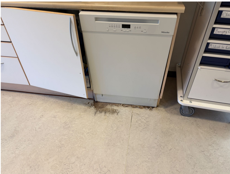
Bilde 23. Typisk omfattende skade på gulvbelegg foran oppvaskmaskin.
