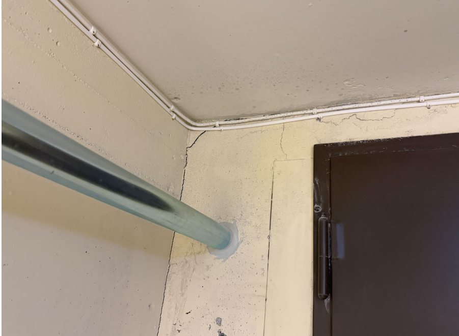
Bilde 1. Sprekkdannelse i vegger i kjeller.
