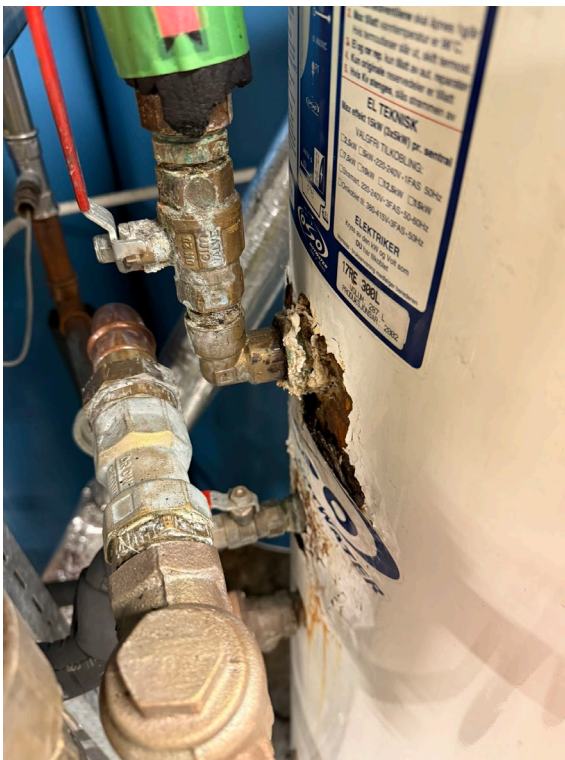
Bilde 29. Skader på bereder fra vannlekkasje.
