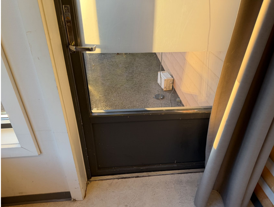
Bilde 14. Typisk slitasje på terrassedør.
