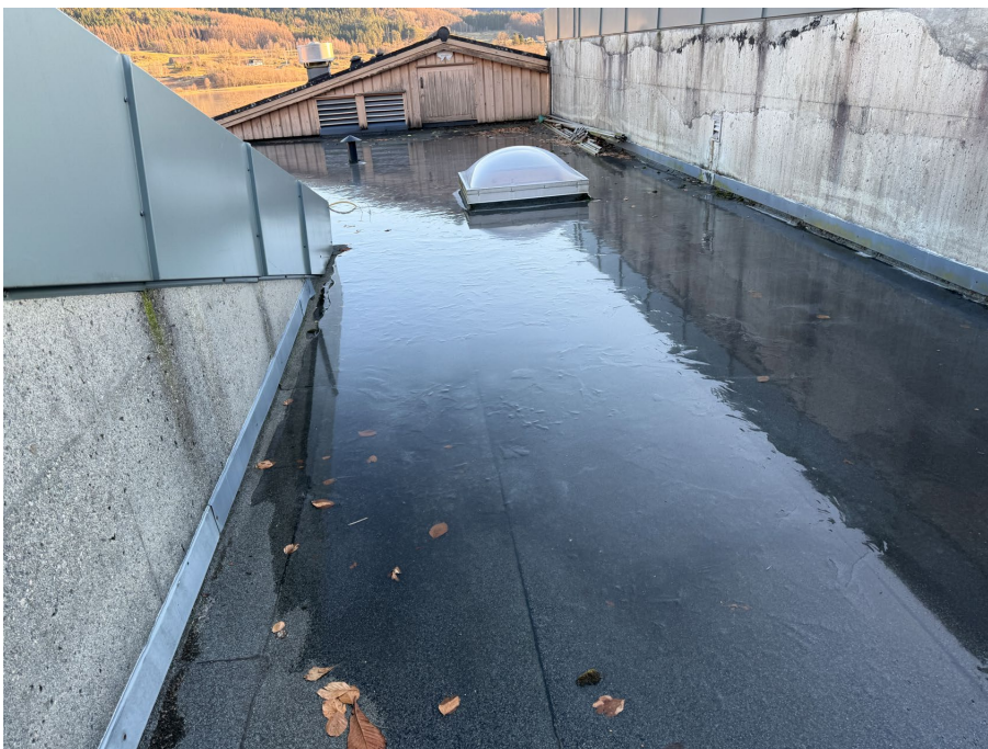
Bilde 17. Yttertak med mangelfullt fall og med kraftige kuldebroer (betongvegger).
