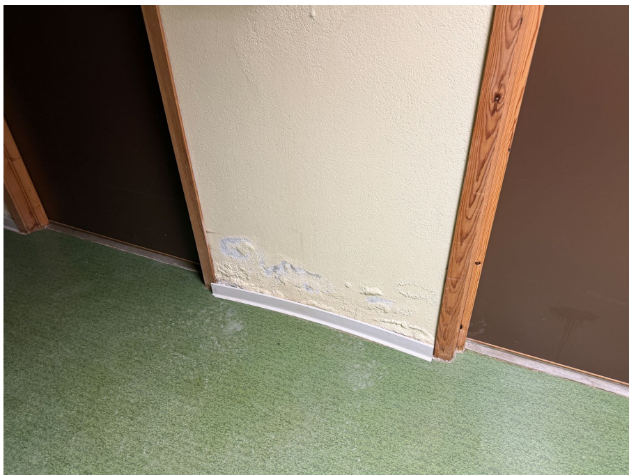
Bilde 3. Innvendige fuktskader på innervegg, 1961-bygget.
