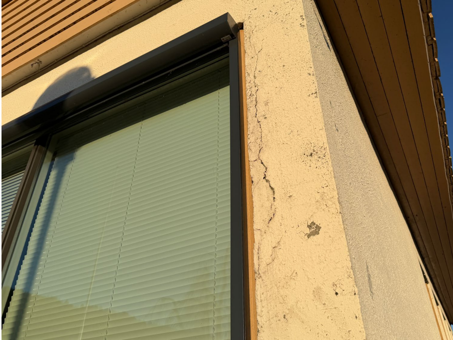
Bilde 5. Betongskader på betongfasader, 1961-bygget.
