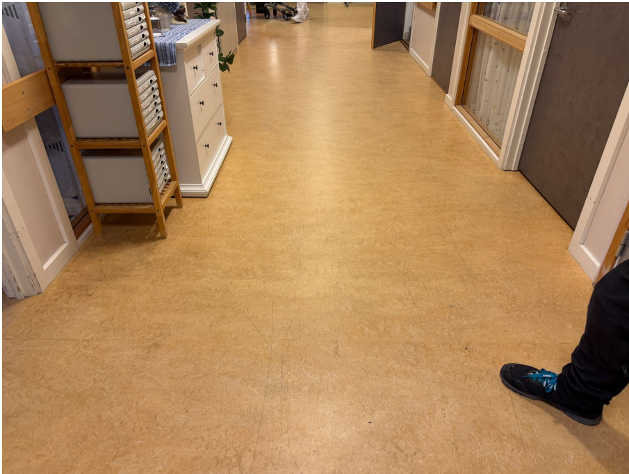
Bilde 22. Typisk slitt gulvbelegg med mindre skader.
