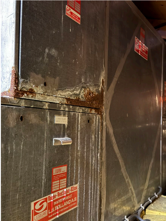
Bilde 33. Ventilasjonsaggregat på tak til 1961-del.
