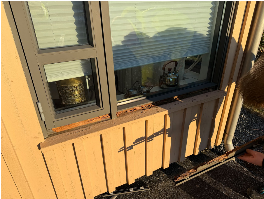
Bilde 12. Kraftig råteskade i vindu.
