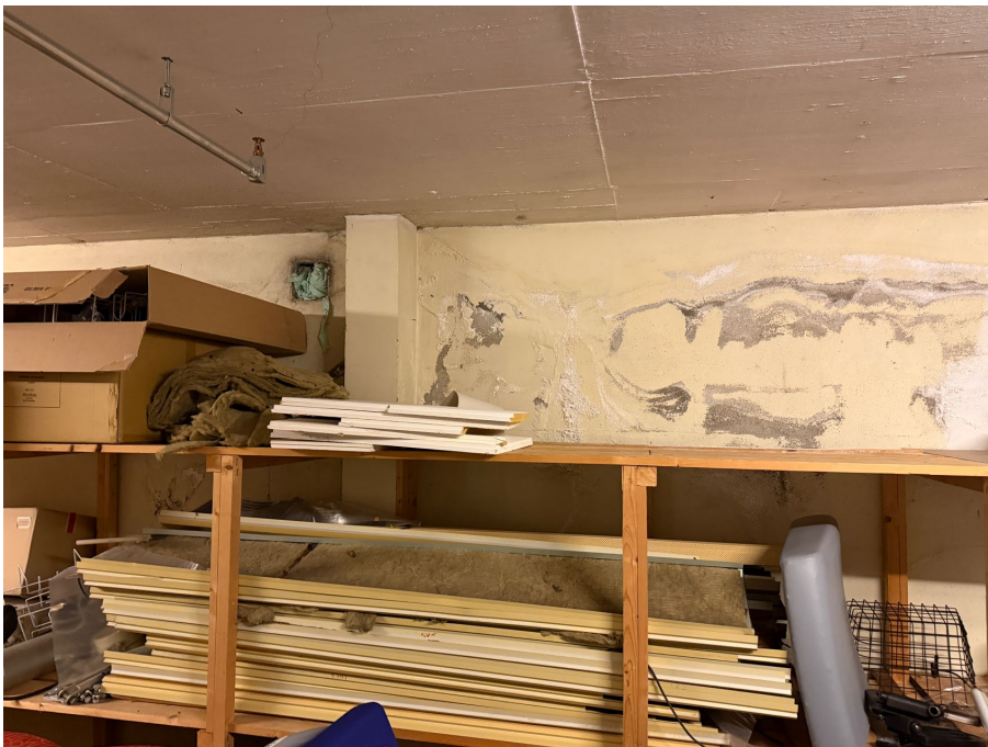
Bilde 2. Innvendige fuktskader på kjellervegg, 1961-bygget.
