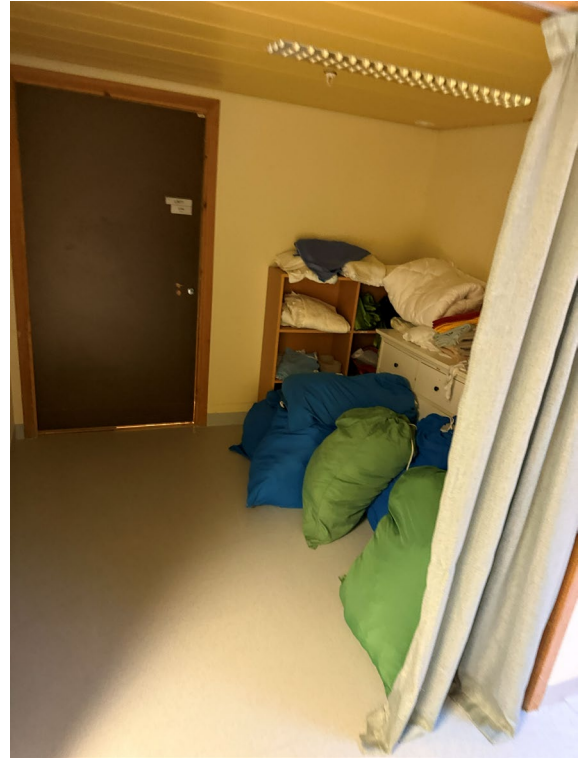
Bilde 57. Lagring i rømningsvei.
