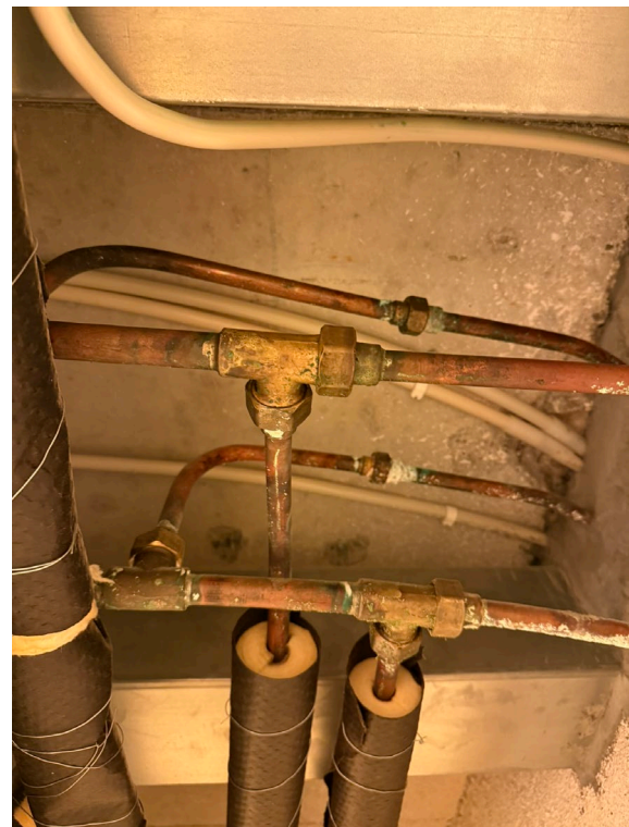
Bilde 30. CU kobber rør med lodde skjøt og union.
