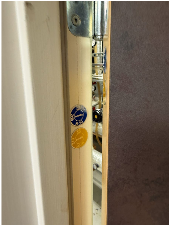
Bilde 58. Eksempel branndør.
