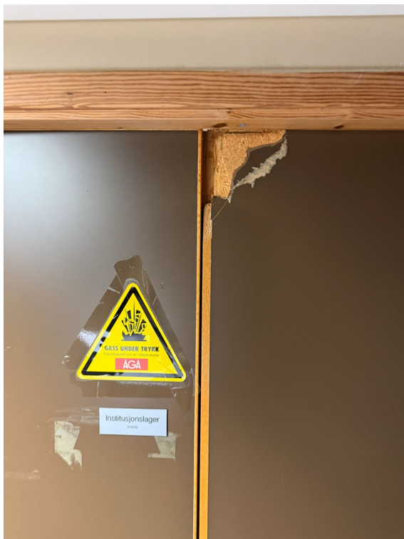
Bilde 60. Skadet branndør
