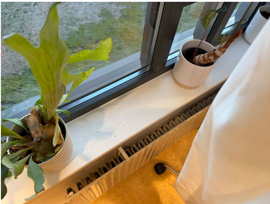
Bilde 13. Typisk fuktskade på foring.
