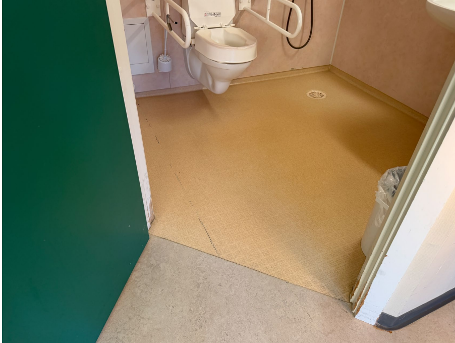
Bilde 24. Skade i skjøt på gulvbelegg på beboerrom.
