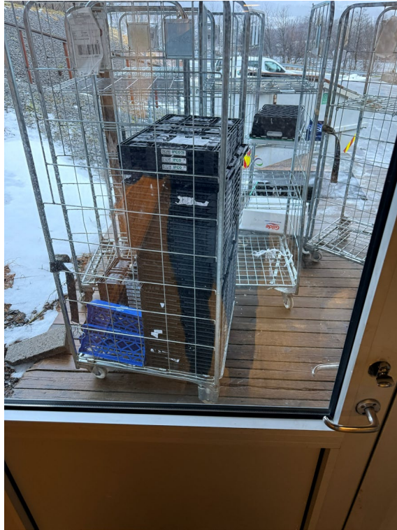
Bilde 56. Blokkering av rømningsutgang.
