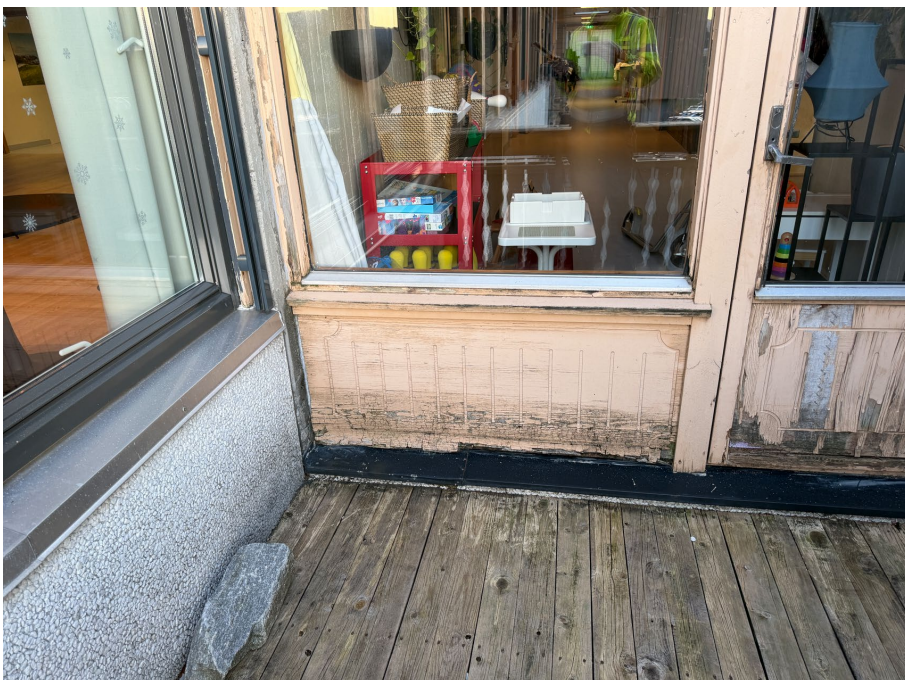
Bilde 9. Råteskader på trekleddning, 1978-bygget.
