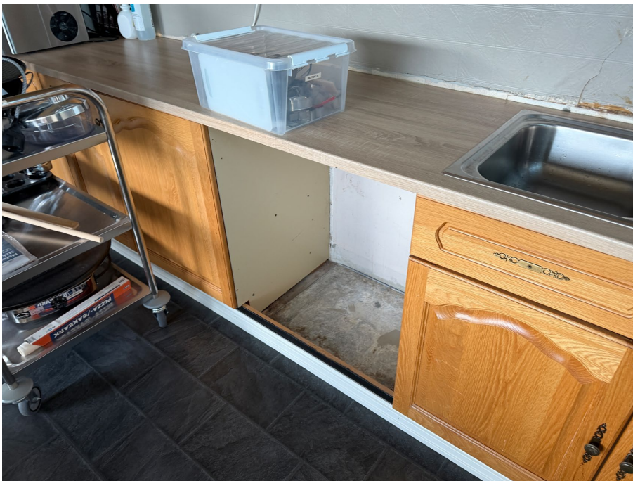
Bilde 26. Eldre kjøkkeninnredning på pauserom med skader.
