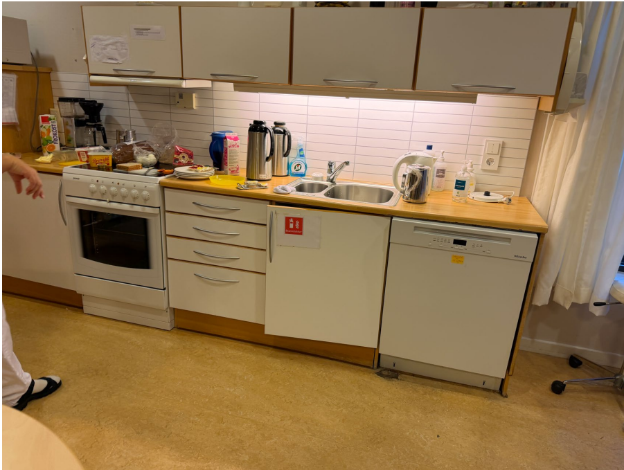
Bilde 27. Kjøkkeninnredning på avdelingskjøkken, med fuktsskadede foringer og benkeplate, samt skade på gulvbelegg.
