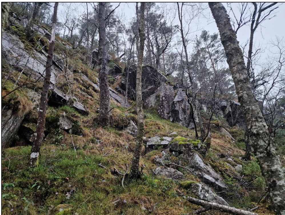
Foto 6: Skrentparti med delvis avløste blokker innenfor løsneområde 1. Foto mot NV.
